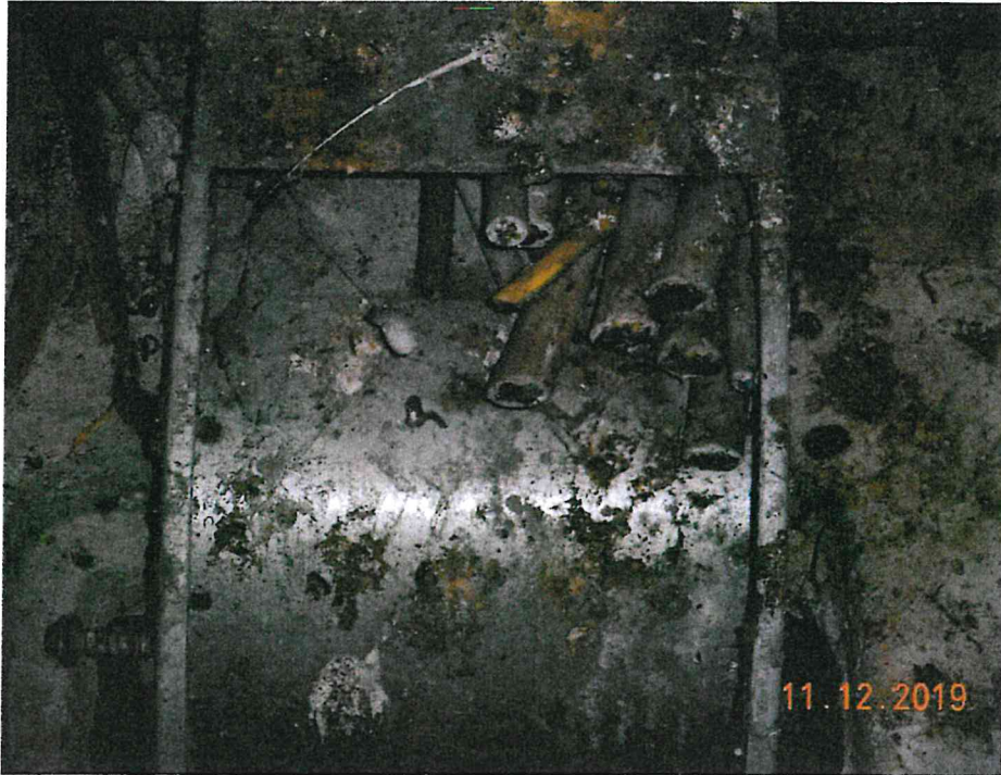
Cavi elettrici asportati
