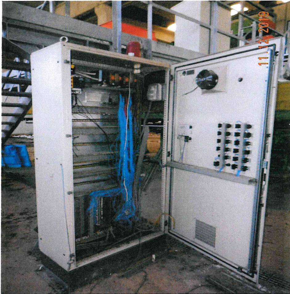
Quadro elettrico e impianto vandalizzati
