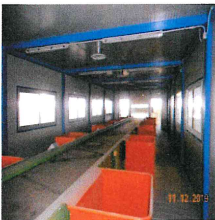
Cabina di selezione - interno
